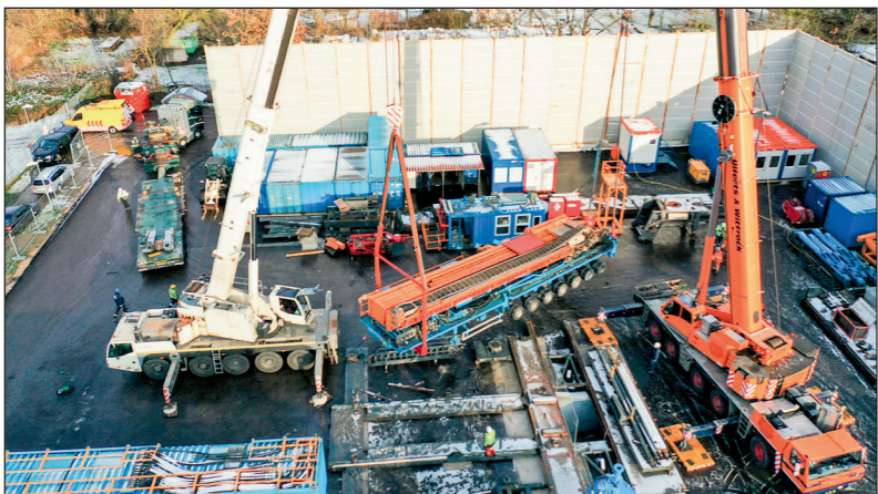
Auf dem künftigen Bohrgelände in Lankow wurde jetzt der Bohrturm aufgestellt. Im Hintergrund steht die Schallschutzwand, die die Emissionen der Anlage mindert. Foto: SWS
